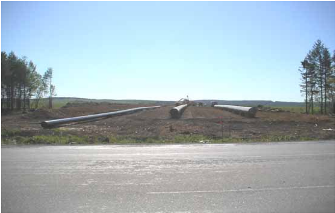
道路の東側に伸びるパイプライン
